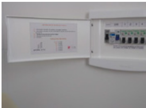
Imagem: QDC instalados na área de serviço
