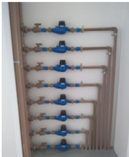
Imagem: Medidores individualizados de água fria
