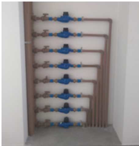
Imagem: Hidrômetros individuais de água fria
