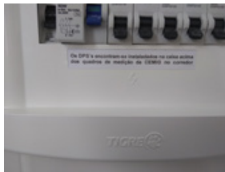
Imagem: Identificação dos disjuntores
