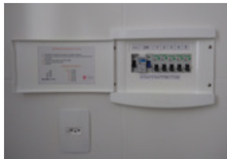
Imagem: Quadro de distribuição de circuitos nos apartamentos
